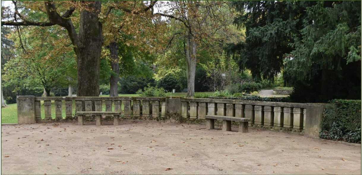
Sanierungsbedürftige Kunststeinbalustrade am Mainblick mit lehnlosen Bänken im Rosengarten
