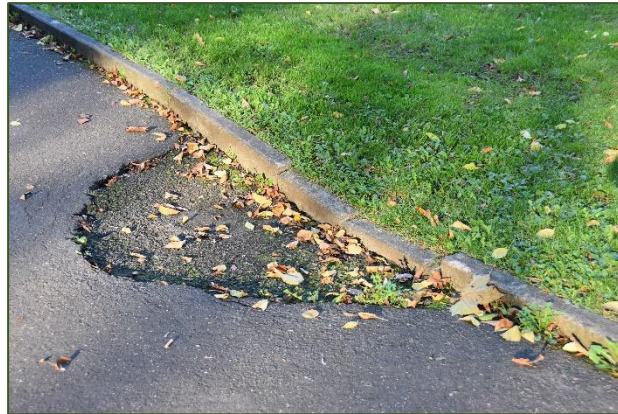
Schadhafter Asphaltbelag, exemplarisch für viele Stadtparkwege
