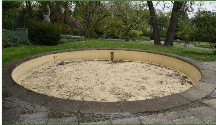
Undichtes Triton-Becken mit Rissen im Beckenboden
