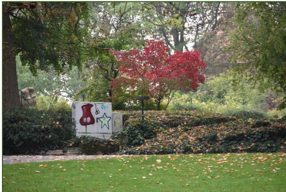
Schaltkasten am Osteingang des Lesegartens
